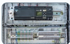
Elektrotechnik Elektroniker/in Betriebstechnik
